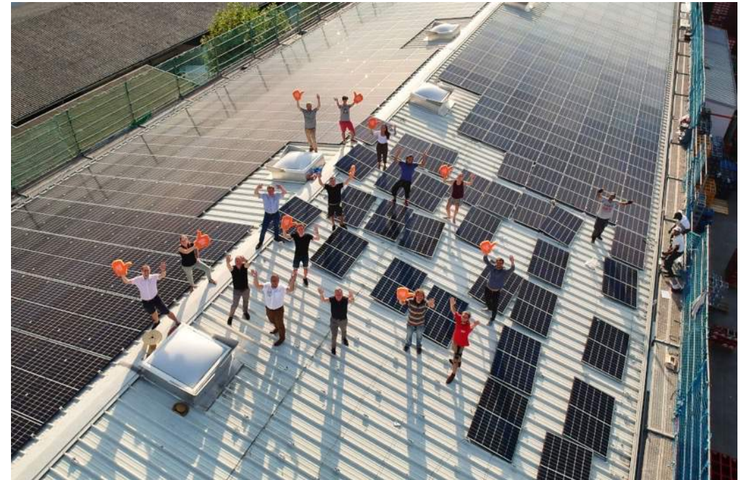
HEG und Bürgerwerke auf dem Dach der Heidelberger Brauerei
